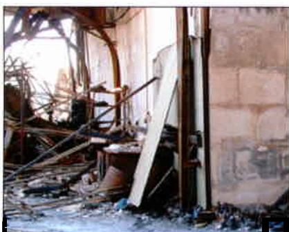
Une cloison en blocs de plâtre après un incendie dans un magasin de stockage à Aalter.
