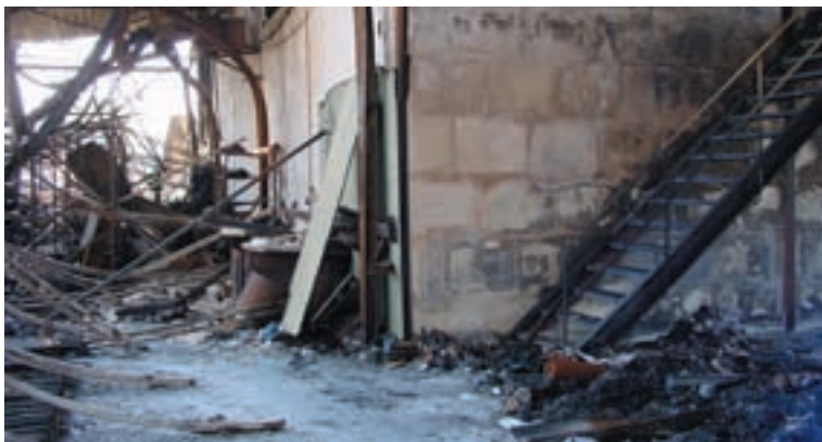
Une cloison en blocs de plâtre après un incendie dans un entrepôt à Alter.
